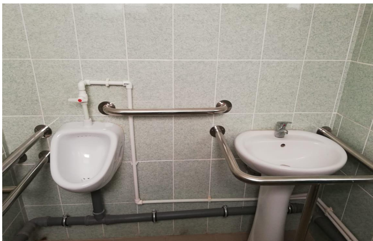
Фото 31,32,33. Санитарно-гигиеническое помещение для инвалидов
